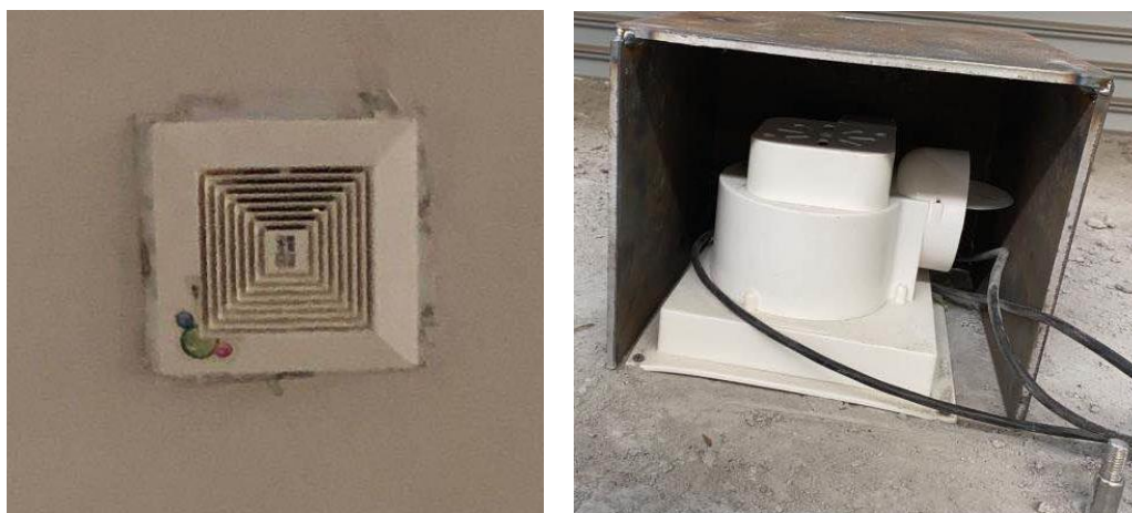
图 4-4 探伤房排风装置
