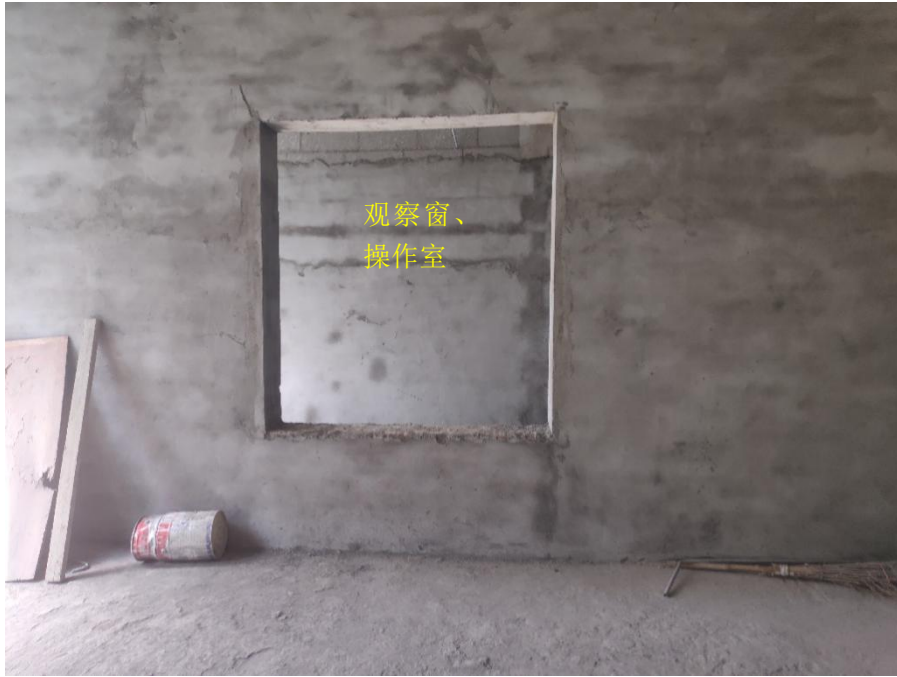
图 8-2 DSA1#机房西侧
