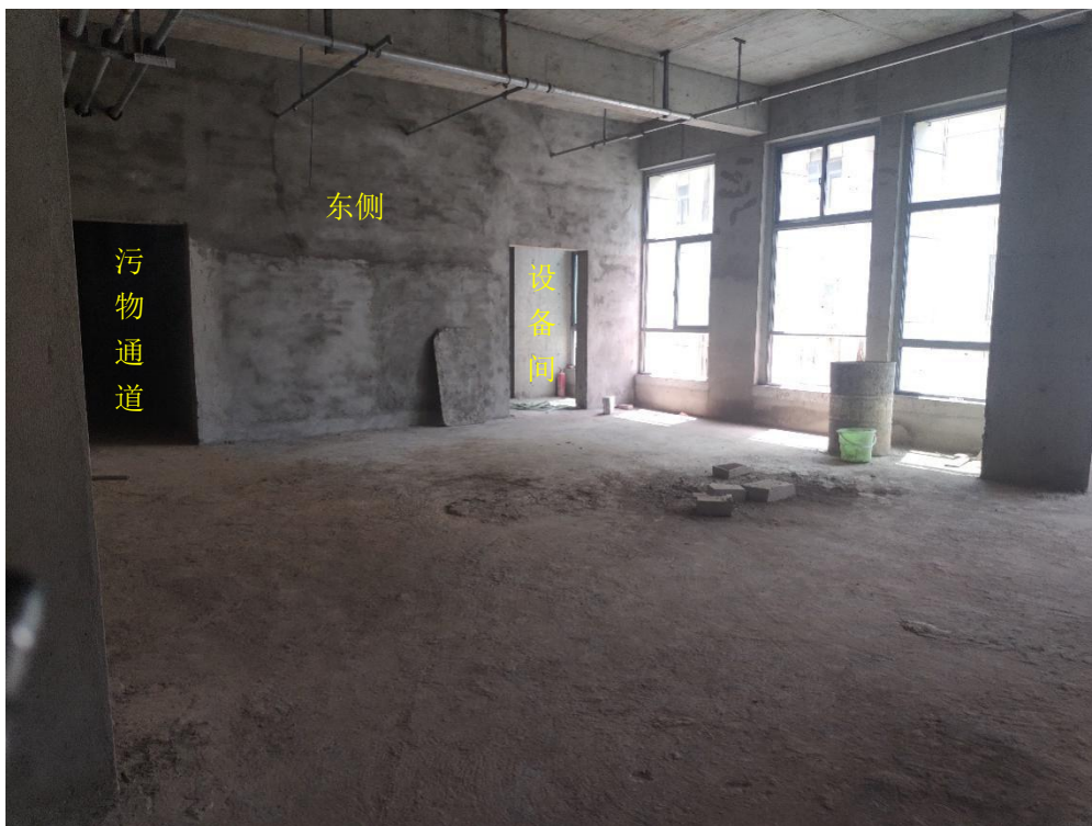
图 8-1 综合病房楼三楼 DSA1#机房
