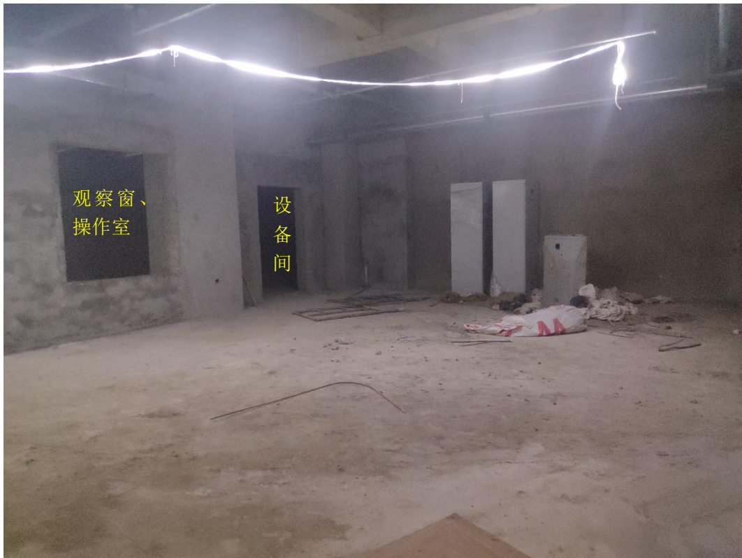
图 8-3 综合病房楼三楼 DSA2#机房
