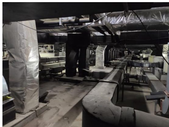
图 8-7 本项目 DSA 机房拟建址楼上 (设备层)
