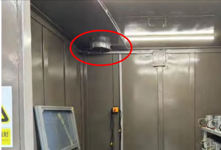
图3-10 本项目铅房内通风现场照片
