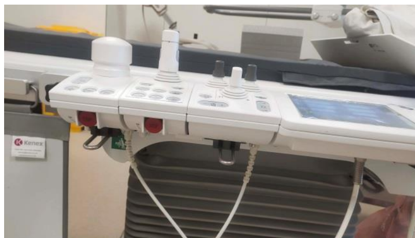
图3-4 DSA机房控制室及机房内的急停按钮
