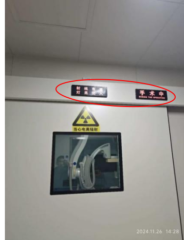
DSA1 室防护大门关闭状态
