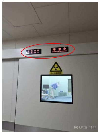
DSA3 室防护大门关闭状态
