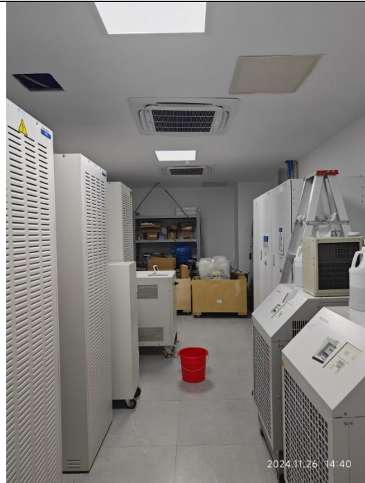
DSA1 室东侧设备间（即 DSA2 室西侧）
