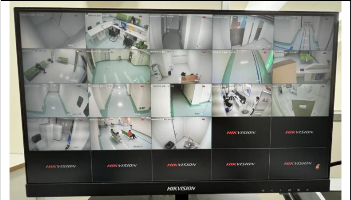
监控终端显示
