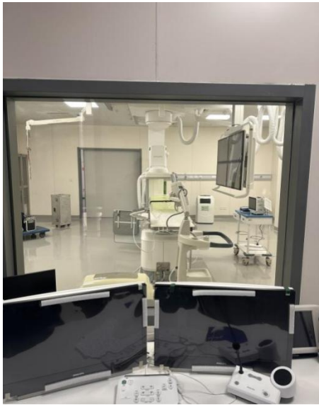
(a) 对讲装置、观察窗（急诊DSA室控制室墙上）
