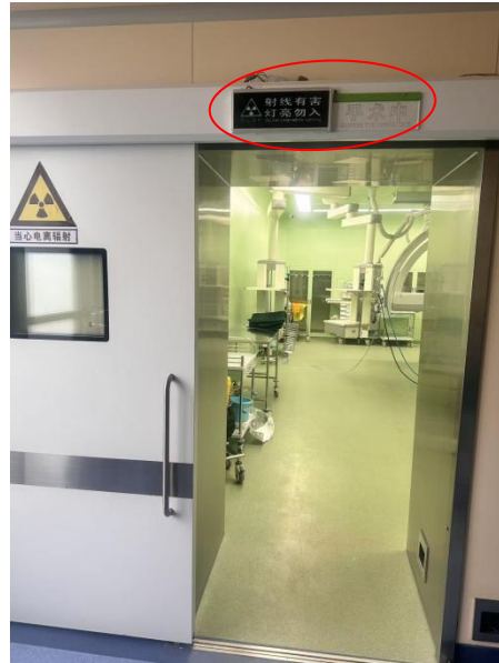
7号楼一楼 DSA 机房防护小门打开状态
