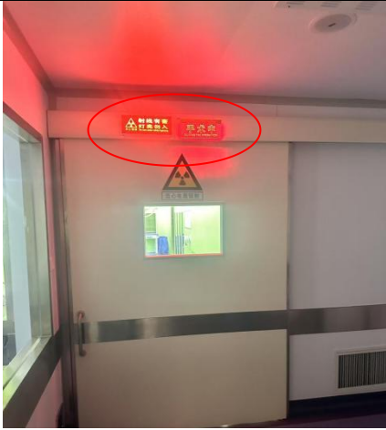
3号楼三楼 DSA3 室防护大门关闭状态
