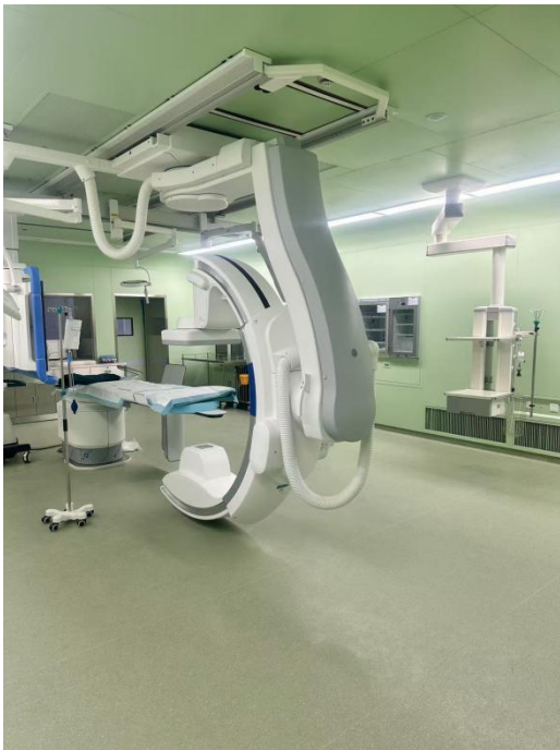
DSA 机房内部
