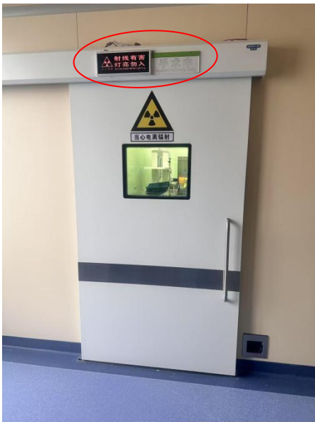
7号楼一楼 DSA 机房防护小门关闭状态
