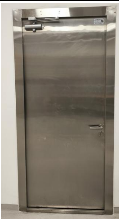
控制室防护门
