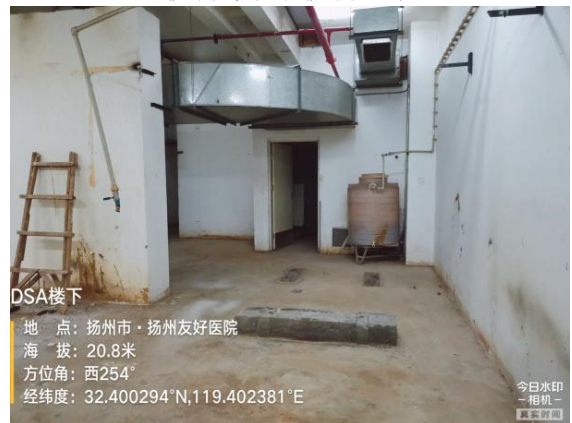
图 8-7 本项目 DSA 机房及配套附属功能房楼下（高压氧舱设备间）
